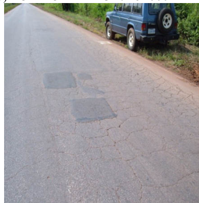
(d) PATCHES AT CH.20+000
