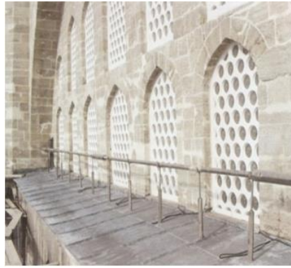
Şekil 10. Mihrimah Sultan Camii gergi düzenlemesi, 2009 [8]
