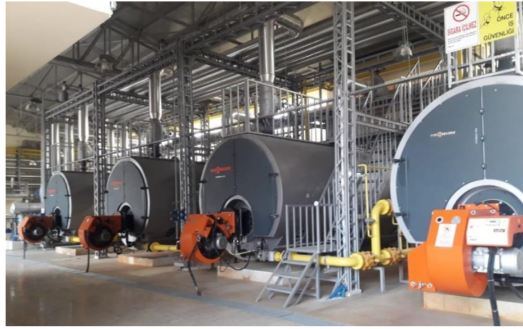
Şekil 1. Enerji ve ekserji analizinin uygulandığı merkezi kazan sistemi
